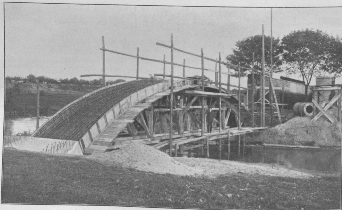
Der Kämpfersteg über die Rednitz in Fürth i. B. Abbildung 10. Aufnahme während der Ausführung, Lehrgerüst.
